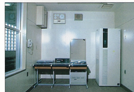
▲ 普通教室棟 1F 放送室
